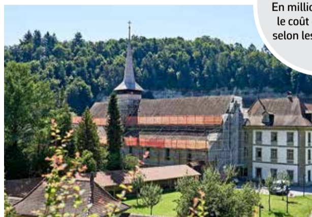
Les travaux ont commencé il y a une année, ils devraient s'achever en 2025.
